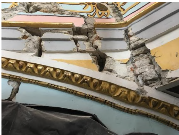
Figura 2. Fractura del tambor de la cúpula encima del arco toral donde se une con la pechina. Fotografía: JECL, 2017.
