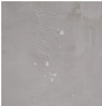
Figura 5 – Descascamento da tinta na área da sacada (residência B)
