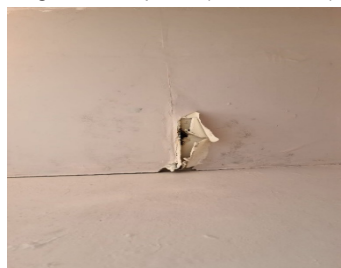
Figura 16 – Deslocamento do forro e goteira no quarto (residência B)
