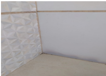
Figura 13 – Deterioração química no revestimento do banheiro (residência B)
