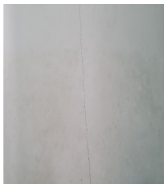
Figura 15 – Fissuras no gesso da sala (residência C)
