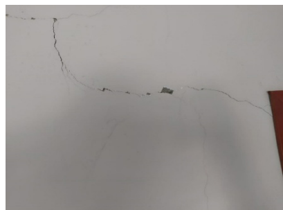
Figura 2 – Fissura por ausência de verga localizada quarto 02 (residência B)
