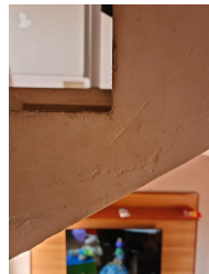
Figura 18 – Fissura por cisalhamento na escada (residência B)
