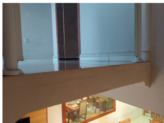
Figura 17 – Fissuras por torção na escada (residência B)
