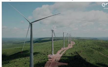
Figura 05 - Parque eólico Lagoa dos Ventos
