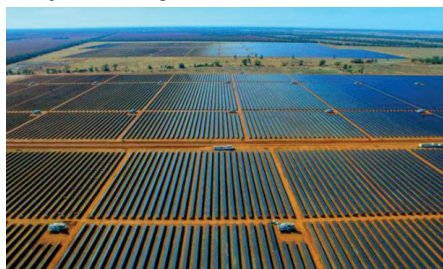
Figura 06 - Parque de energia solar de São Gonçalo do Gurguéia.
