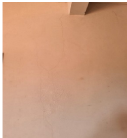
Figura 3 – Fissura por ausência de junta de dilatação térmica localizada na cozinha
