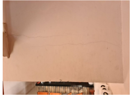
Figura 10 – Ausência de ligação entre viga/alvenaria (residência B)
