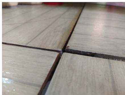
Figura 12 – Deterioração das juntas do revestimento na sala (residência A)
