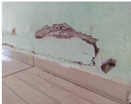
Figura 6 – Descolamento do reboco (residência A)
