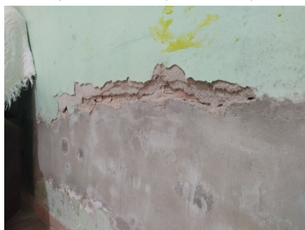
Figura 8 – Umidade ascendente parede da sala (residência A)
