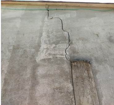
Figura 9 – Ausência de ligação entre pilar/alvenaria parede externa do quarto 03 (residência A)
