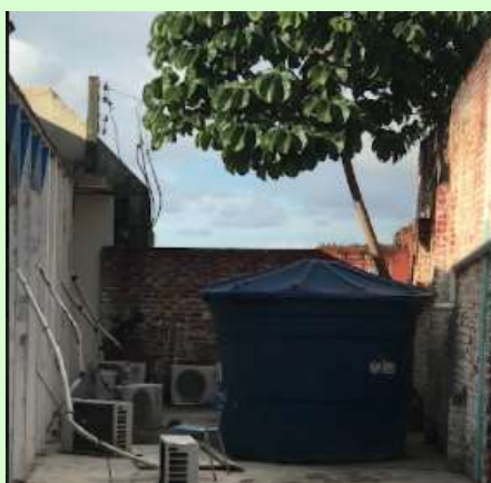
Reservatório de captação de água de chuva
