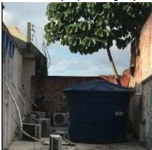
Imagem 20. Sistema de captação de água pluvial do CEHMA.
