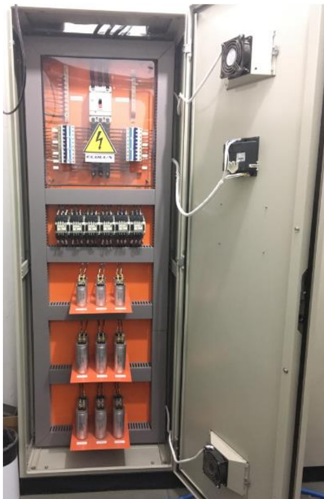
Figura 76 – Painel elétrico do banco capacitivo correspondente ao QGBT- 4
